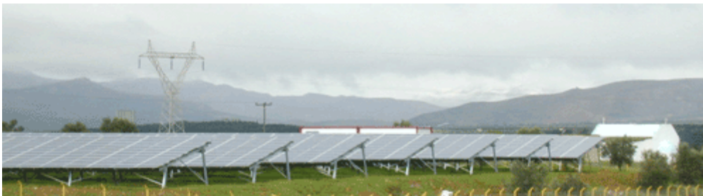
Φωτοβολταϊκός σταθμός ηλεκτροπαραγωγής (μεσαίου μεγέθους)
